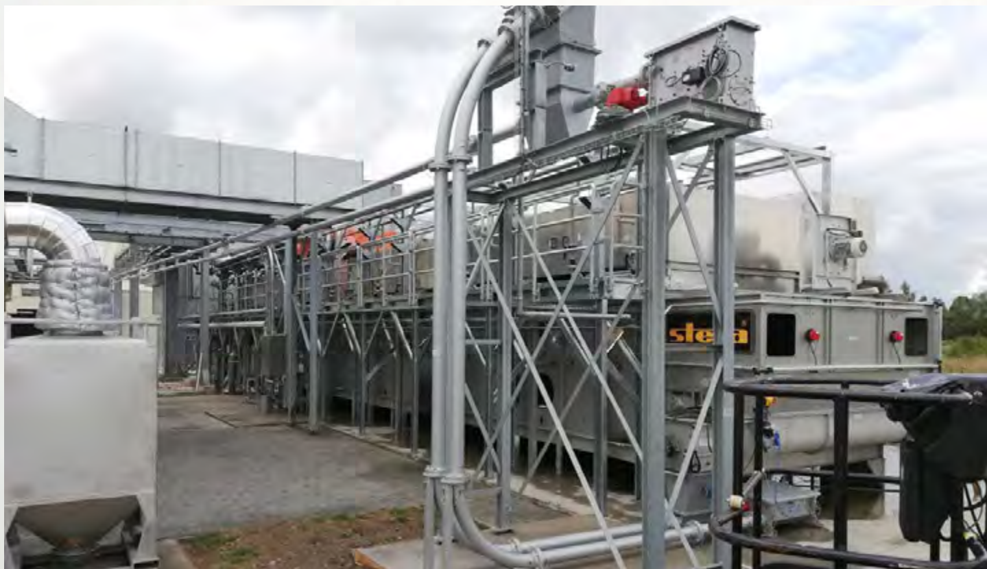
项目地: Ecoson Belgie BVBA, 比利时 | 型号: BTLU 1/3000-25 | 安装年份: 2019 干燥物料: 消化污泥 | 蒸发量: 1.5吨/小时
